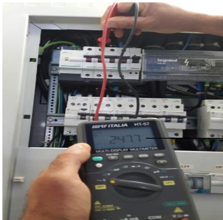
Fotografía 3. Captación de Medida en Cuadro General Eléctrico. Tensión entre fase y neutro 247,7 Voltios
