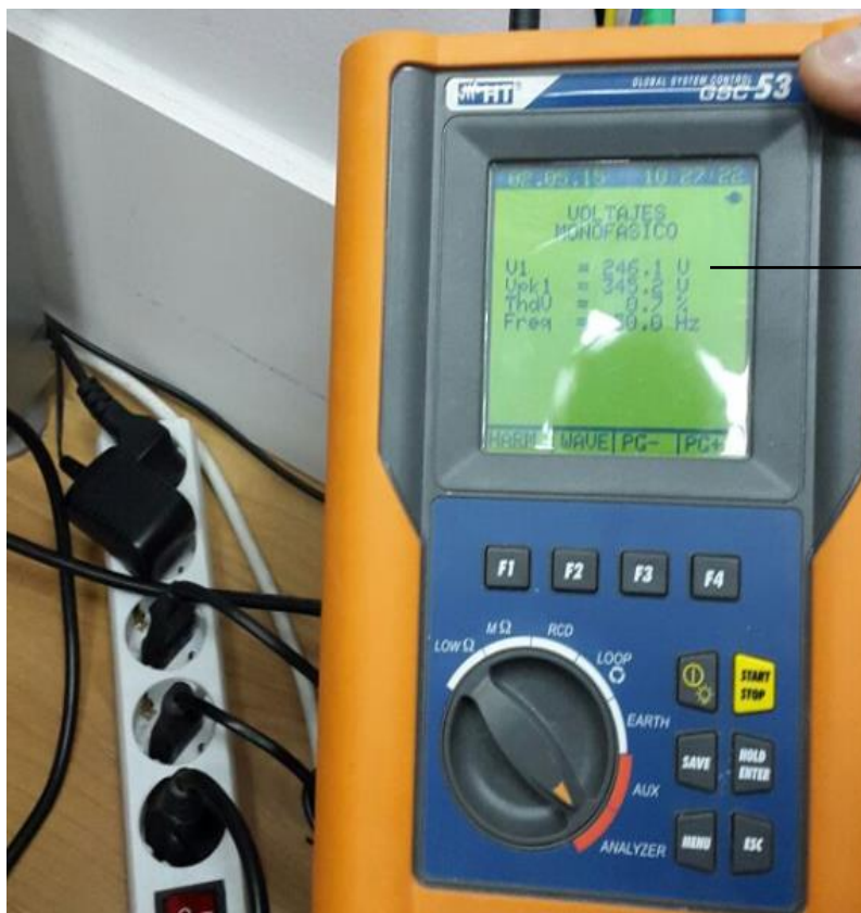
Fotografía 1. Captación de medida realizada en una toma de corriente del local. Tensión entre fase y neutro 246,1 Voltios
